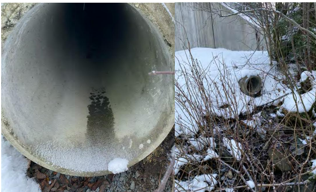
Figur 14. Utløp stikkrenne øst i reguleringsområdet. Punkt 9 i Figur 3. Stikkrennen har dimensjon på 300 mm og er i god stand.
