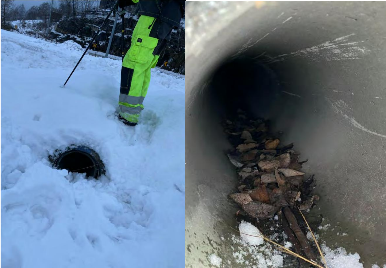
Figur 10. Innløp stikkrenne i grøften under innkjøringsvegen til Nordsetervegen 311. Punkt 4 i Figur 3. Grøften foran innløpet var dekket av snø.
