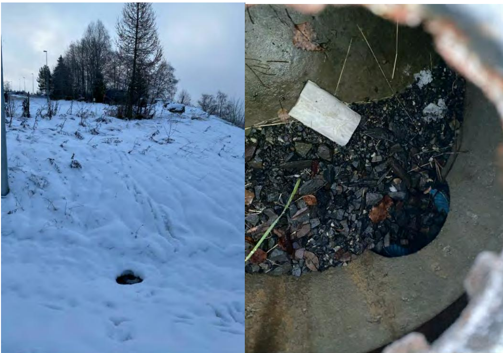
Figur 12. Innløpsrist i grøft på innsiden av gangvei i svingen nord for reguleringsområdet. Punkt 7 i Figur 3. Det går et rør mot inntaket i Figur 11, som er delvis tettet av sedimenter.
