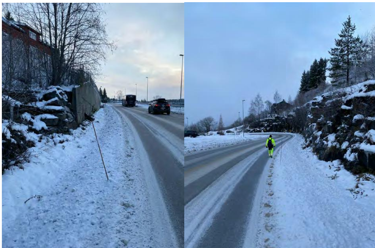
Figur 9. Veggrøft nordøst for Nordsetervegen, oppstrøms for reguleringsområdet. Bildet tatt fra punkt 3 i Figur 3. Grøften er dyp de fleste steder, men er dekket av mye snø fra brøyting av veggen.
