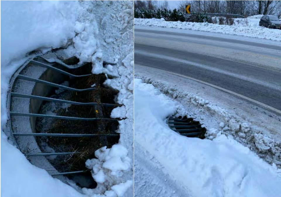
Figur 11. Innløpsrist på innsiden av Nordsetervegen i svingen nord for reguleringsområdet. Punkt 6 i Figur 3. Risten er delvis dekket av snø og det ble observert hjulspor over risten. Røret under risten er delvis tettet av sedimenter.
