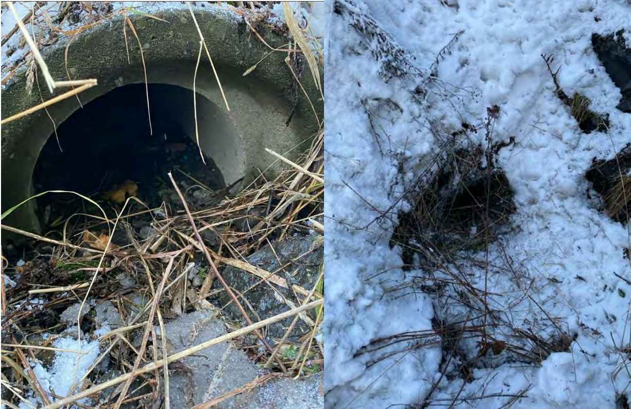
Figur 8. Stikkrenne oppstrøms planområdet, i krysset Bergsvevegen-Nordsetervegen (Punkt 2 i Figur 3). Stikkrennen har dimensjon på 300 mm. Men innløpet er tettet av sedimenter, vegetasjon og snø, som reduserer kapasiteten betydelig.
