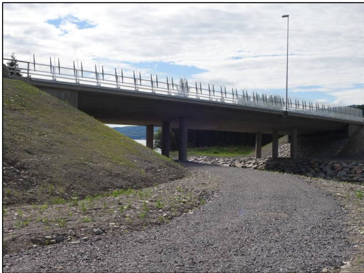
Figur 24: Eksisterende bru E6 over Rinda, sett fra oppstrøms side (Bilde fra Brutus)
