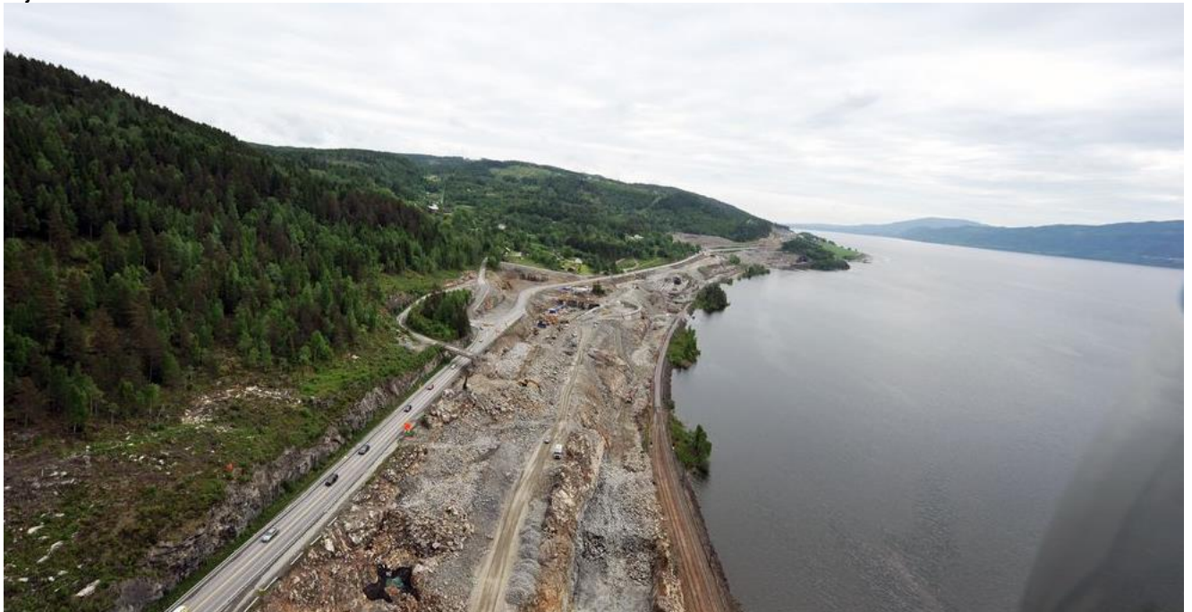
Figur 8-1. Fellesprosjektet E6 og ny Dovrebane langs Mjøsa endte opp med å bli lagt på fyllinger i strandsonen over flerfoldige kilometer. Prosjektet føyer seg med dette inn i rekken over store tunge inngrep som har fragmentert kantsonene og endret gruntvannsområdene langs Norges største innsjø.
