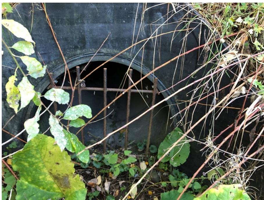
Figur 5. Innløp til overvannsledning 800 mm med utløp i Bæla.
